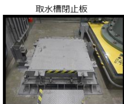
取水槽閉止板
