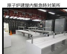
原子炉建屋内緊急時対策所
