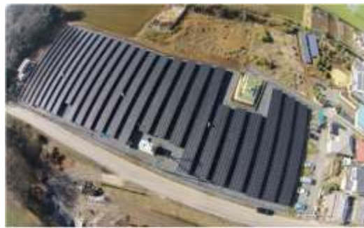
茨城県筑西市 544kw ソーラーフロンティア
