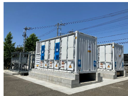
相模原蓄電所
