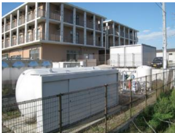
福祉施設（スプリンクラー設備）
